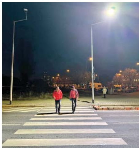
Přisvětlením se na devítce staly bezpečnějšími i přechody pro chodce v Lovosické ulici
